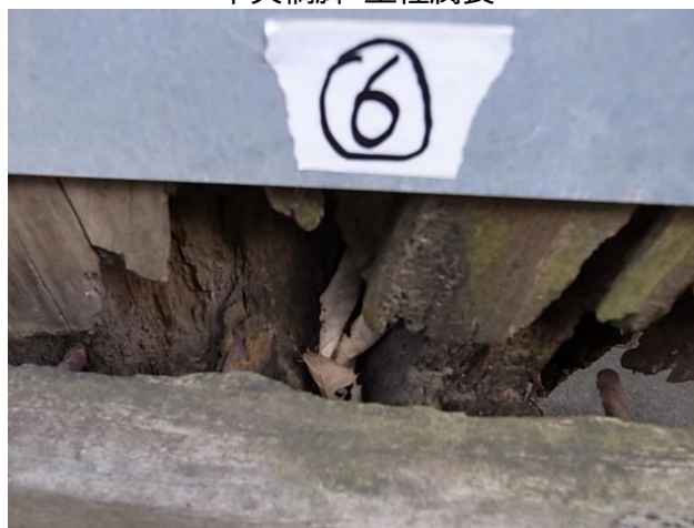
中央橋脚:主柱腐食
