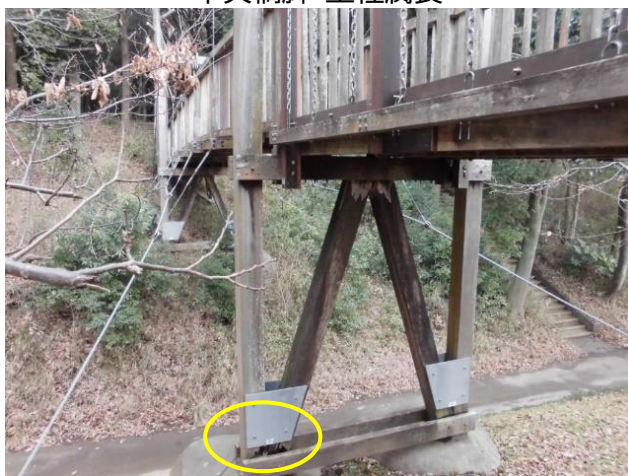
中央橋脚:主柱腐食
