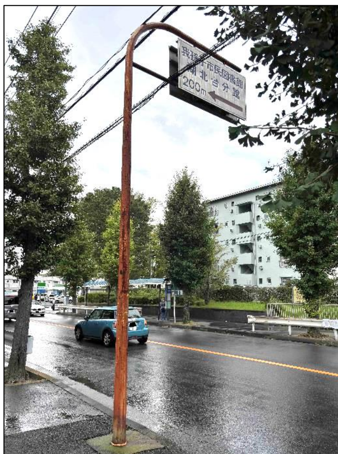
さびの生じた案内看板
