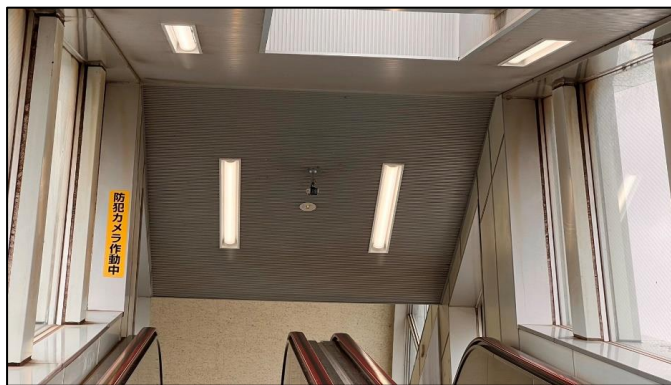
布佐駅南口エスカレーター上照明
