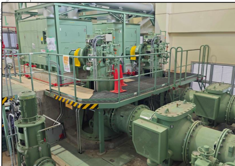
▲更新後の雨水排水ポンプ
