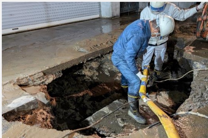
塩化ビニル管の破損による漏水(令和7年2月 若松)
