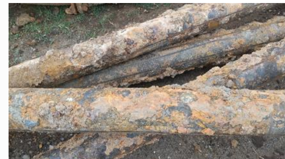
老朽化により腐食した鋳鉄管
