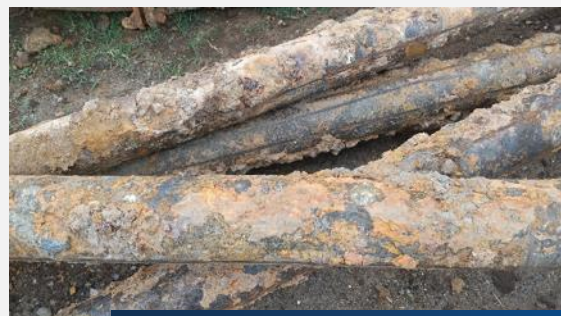
老朽化により腐食した鋳鉄管
