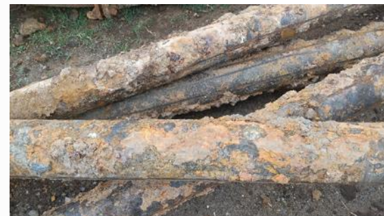
老朽化により腐食した鋳鉄管
