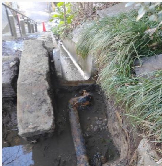
鋼管の破損による漏水(令和6年1月 寿)
