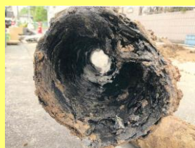
下水管（Zパイプ）
