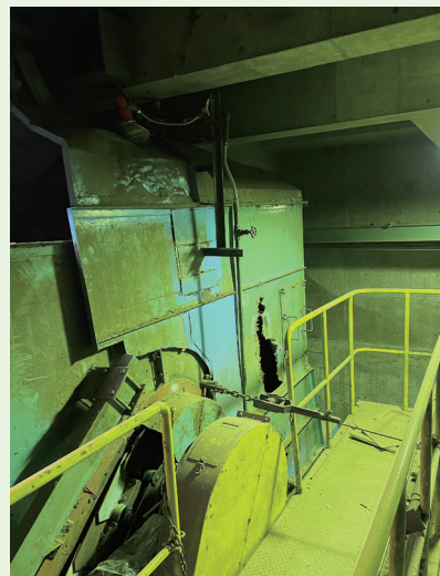
▲老朽化した破碎機
