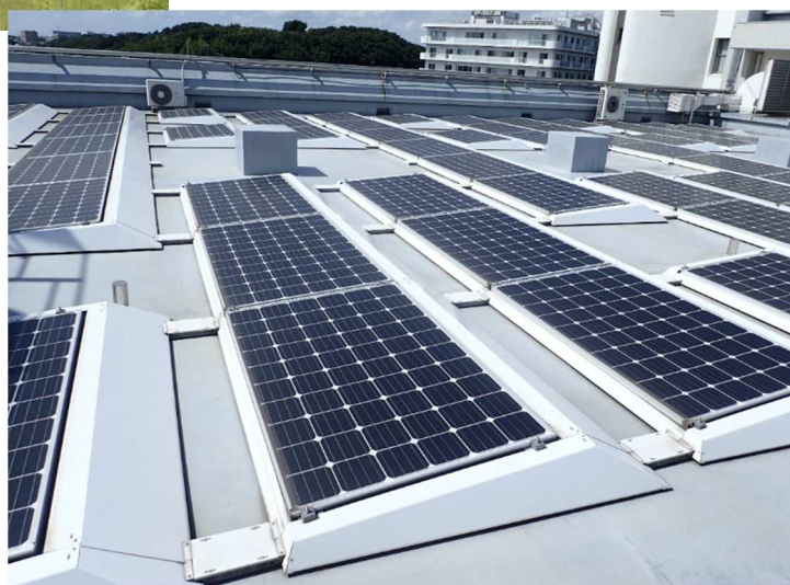
市内公共施設に設置された太陽光パネル
