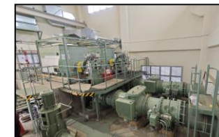
雨水排水ポンプ(施工後)
