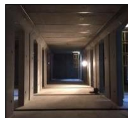
地下式調整池
