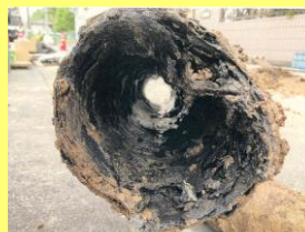
下水管（Zパイプ）
