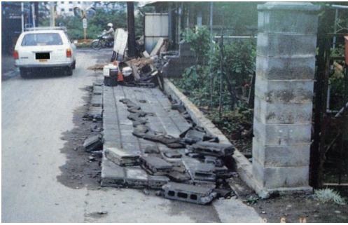
▲宮城県沖地震発生時に倒壊したブロック塀
