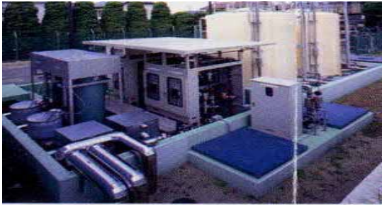
（次亜塩素貯留槽及び注入機器）
