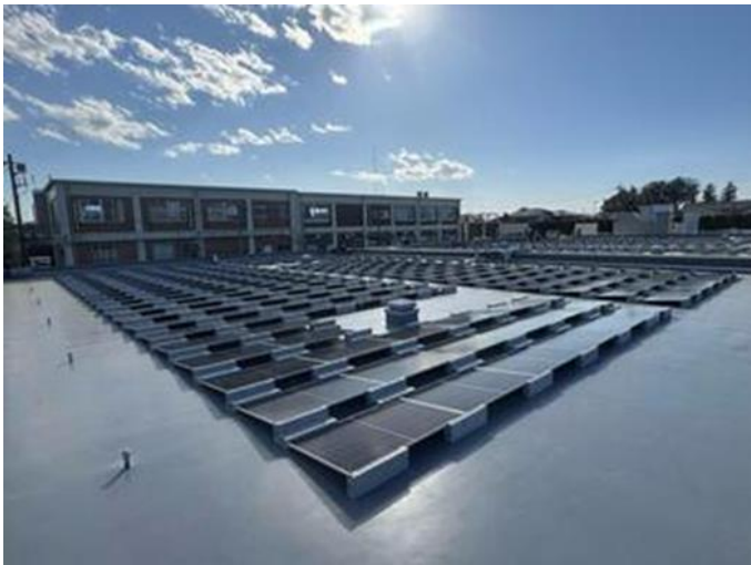
写真1 太陽光発電設備(水道局 湖北台浄水場)
